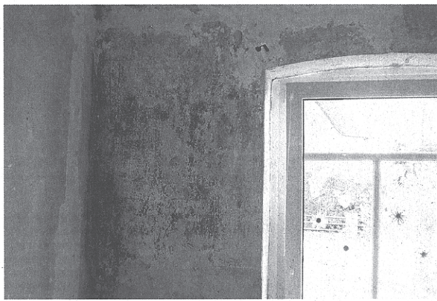
Schwarz-schimmelige Wände gehören nach der Behandlung mit Hygrospan der Vergangenheit an. Foto: Hygrospan
